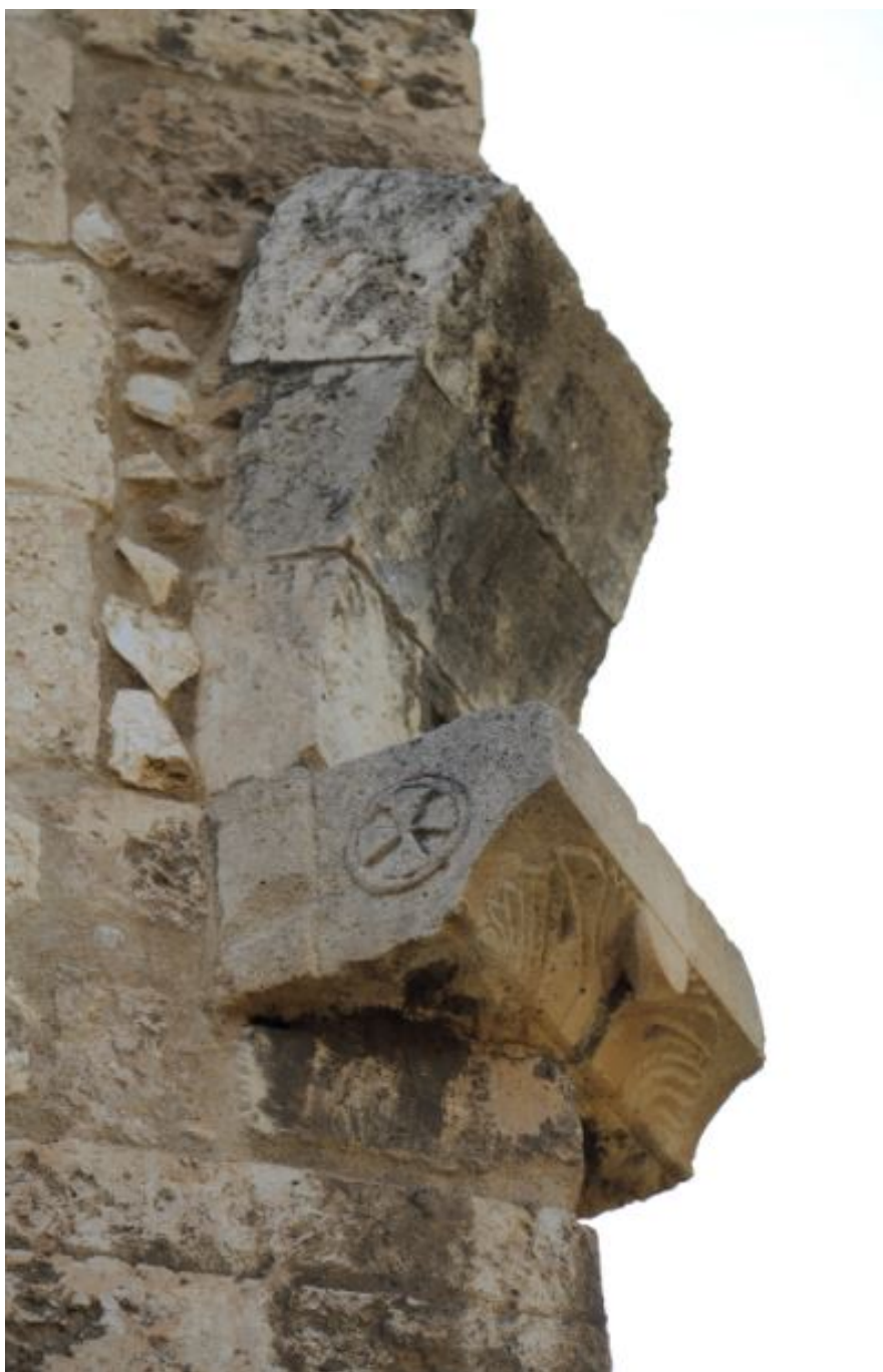
Fig. 1 - Mensola in rottura all'esterno del corpo cupolato (foto di Unicity S.p.A.).
