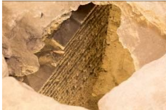
Fig. 2 - Parete interna del condotto fognario
