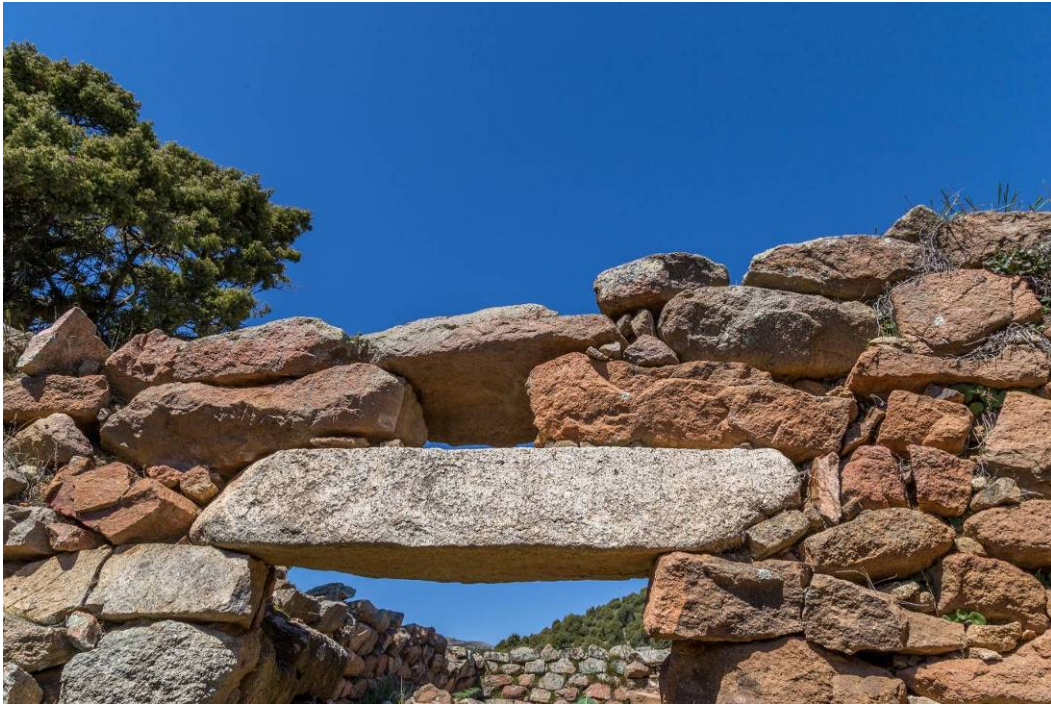
Fig. 2 - Ingresso architravato del vano C del tempio a megaron 1 (foto di Unicity S.p.A.).
