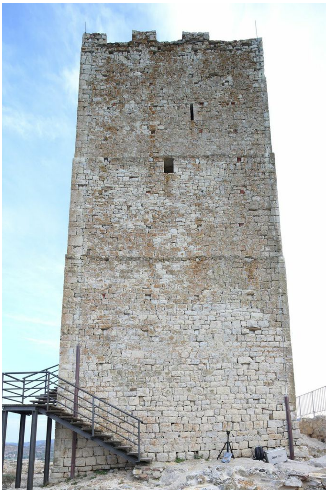
Fig. 4 - Il lato Nord della torre: nel paramento murario si notano le riseghe che segnano i tre piani dell'edificio (foto di Unicity S.p.A.).
