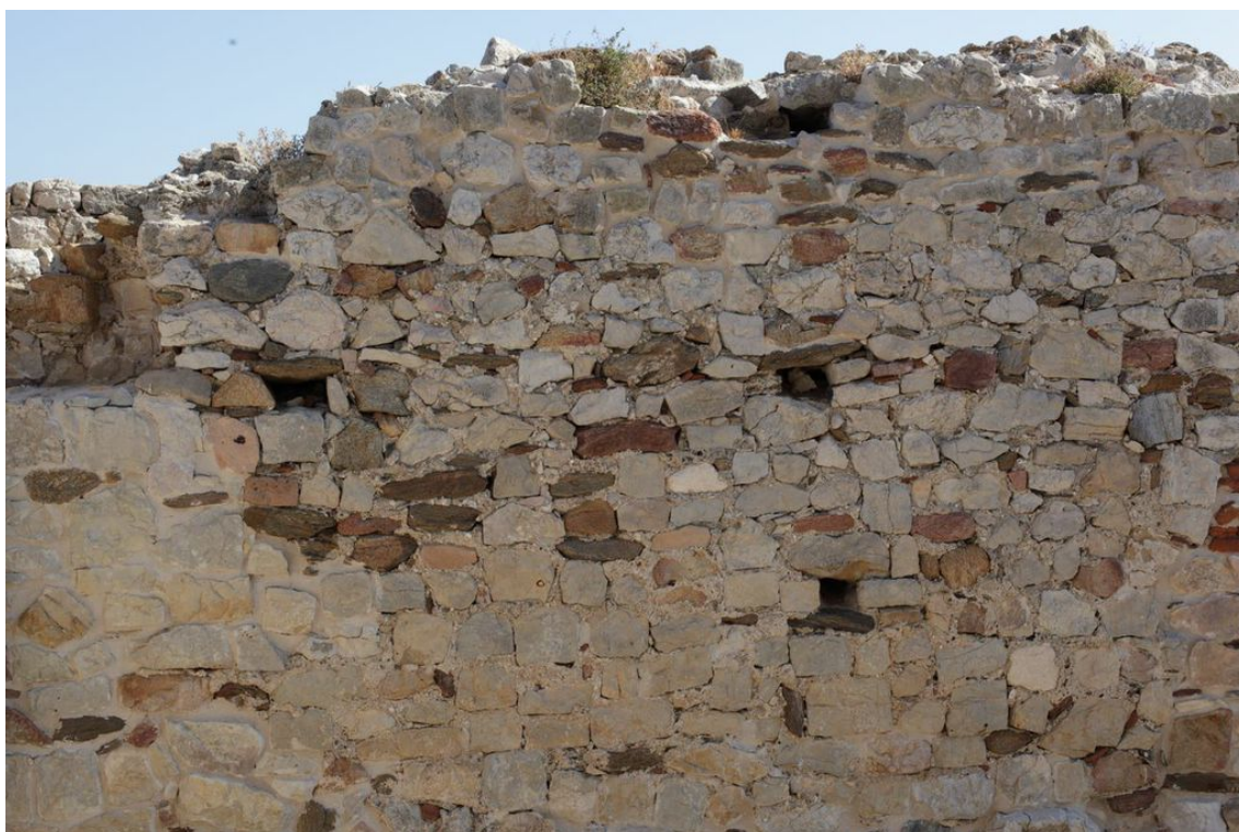
Fig. 3 - Fori di alloggiamento di travi lignee, disposti in verticale (foto di Unicity S.p.A.).
