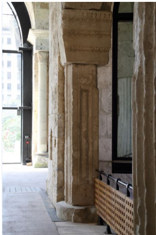
Fig. 1 - Éléments architecturaux de réutilisation (entablement, architrave) dans le mur de séparation de la nef de gauche du bras oriental (photo Unicity S.p.A.).
