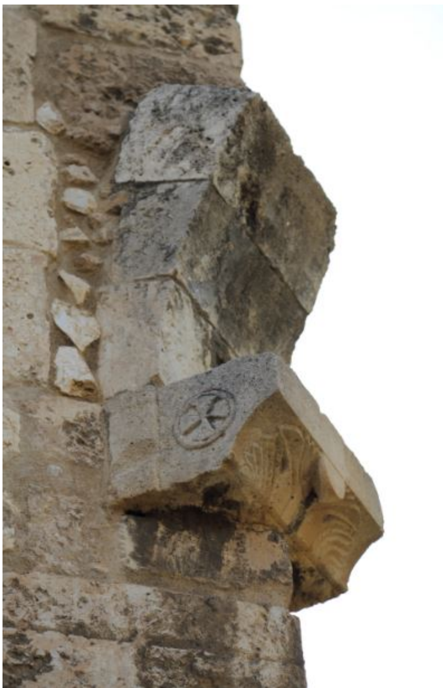
Fig. 1 - Corbeau en rupture à l'extérieur du corps à coupole (photo Unicity S.p.A.).
