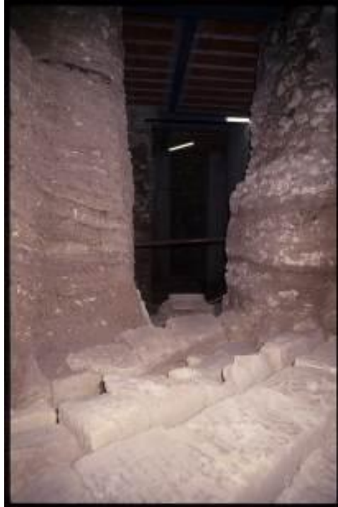
Fig. 2 - Sept rangées de blocs équarris (premier effondrement), (photo AFS).
