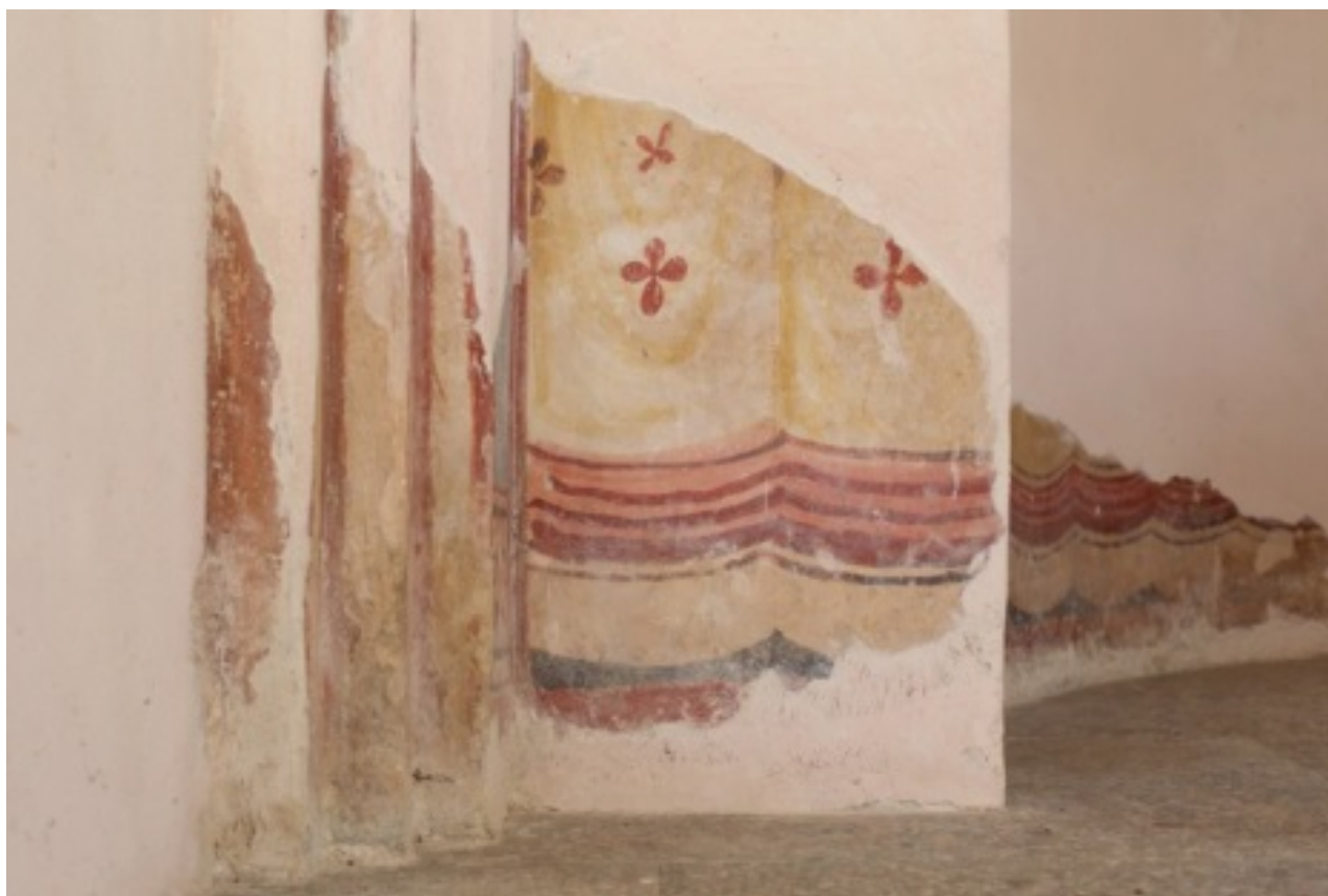
Fig. 1 - Le faux vélarium dans la partie inférieure de l'abside (photo Unicity S.p.A.).
