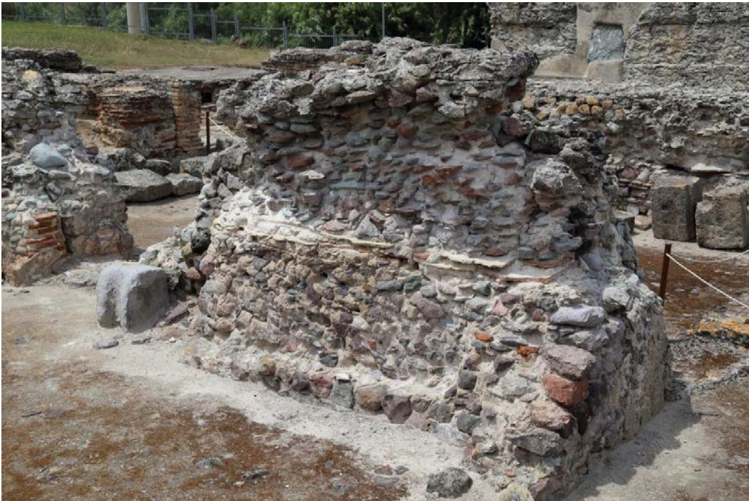
Fig. 4 - Mur du tepidarium avec les signes évidents de la forte érosion qui a mis à nu la structure interne du mur (photo Unicity S.p.A.).
