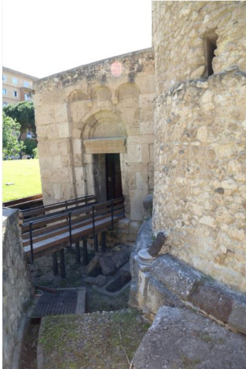
Fig. 1 - Vista del portal externo de la nave derecha del brazo oriental (foto de Unicity S.p.A.).
