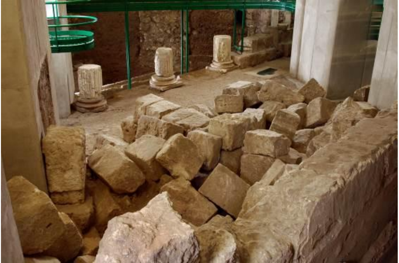
Fig. 2 - El segundo derrumbe visto desde la parte trasera del pórtico (foto de AFS).
