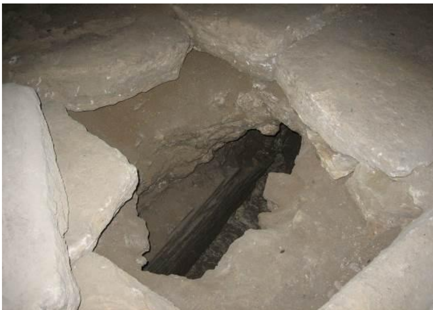
Fig. 1 - Conducto del alcantarillado durante las actividades de excavación (foto de Unicity S.p.A.).
