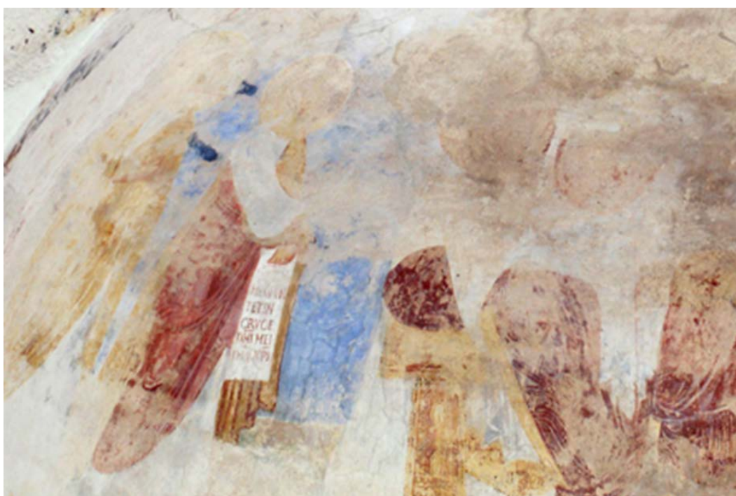
Fig. 3 - Frescos en la bóveda absidal: Cristo en Majestad (foto de Unicity S.p.A.)
