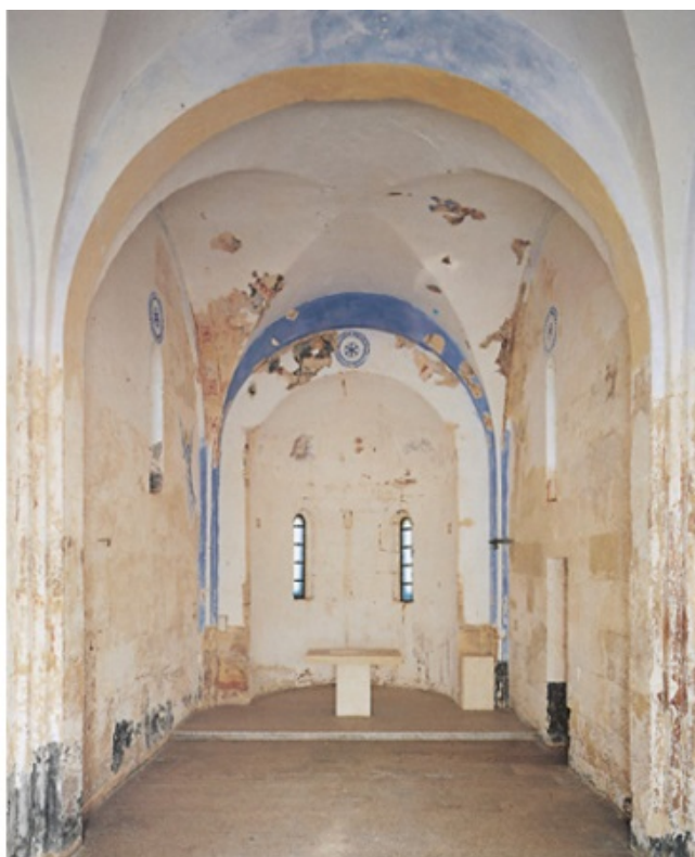
Fig. 3 - Interior de la iglesia de S. Nicola di Trullas antes de las restauraciones de 1997 (foto del Ayuntamiento de Semestene)
