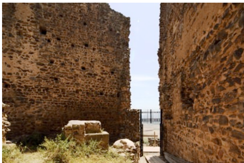
Fig. 9 - La entrada del torreón vista desde el interior tras su restauración (foto de Unicity S.p.A.).
