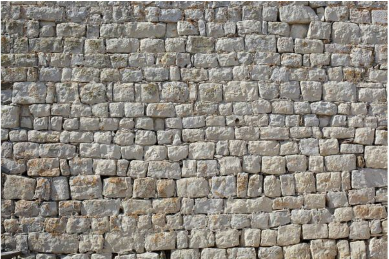
Fig. 2 - Detalle de los muros de la torre, con filas de bloques escuadrados de piedra local (foto de Unicity S.p.A.)
