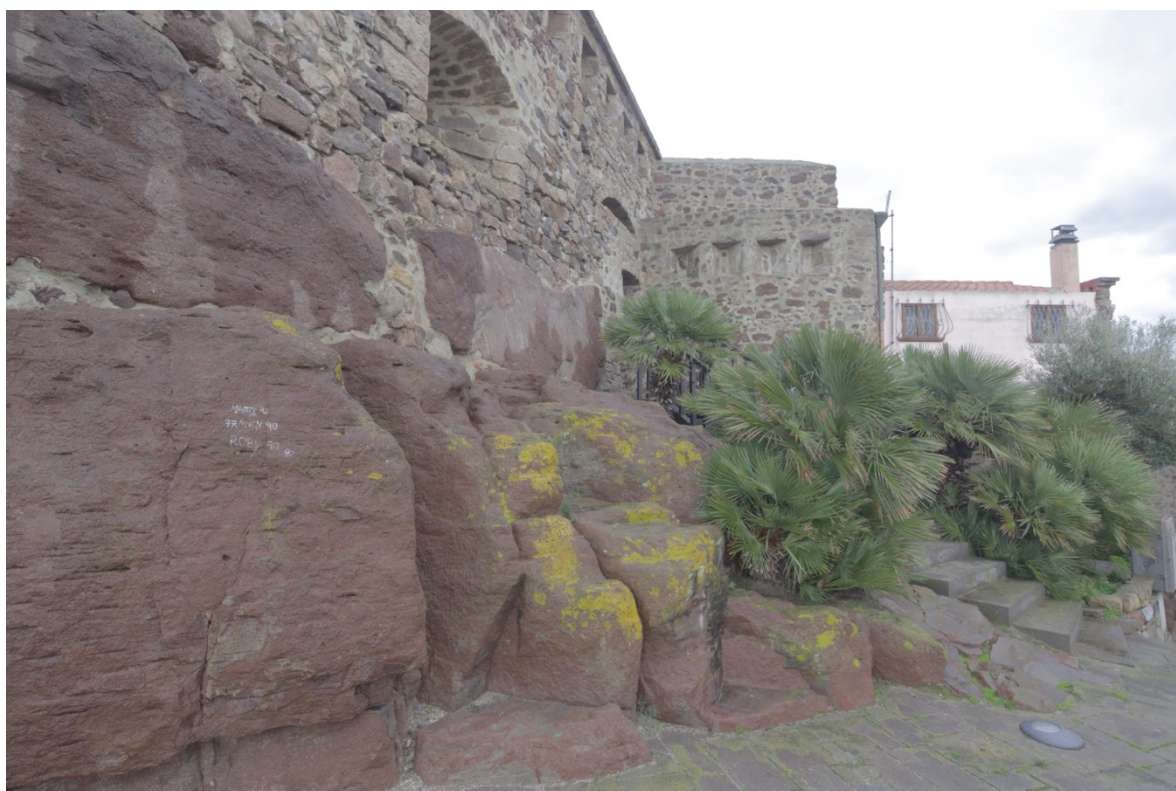
Fig. 1 - Fuerte Su Pisu. Detalle de los restos de los bloques de traquita del nuraga (foto de Unicity S.p.A.).
