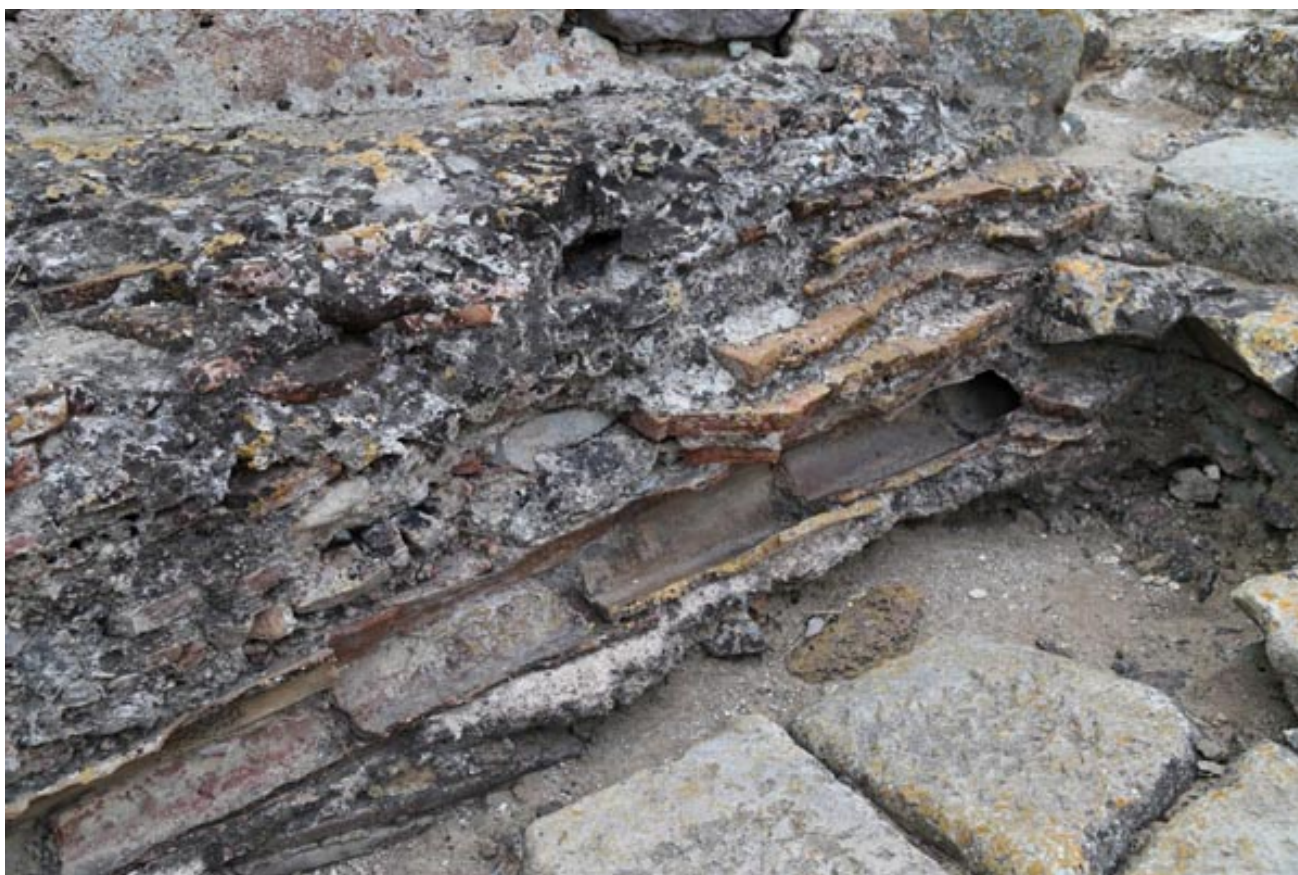
Fig. 3 - Canaleta que en un principio se encontraba dentro de un ambiente cerrado (foto de Unicity S.p.A.).
