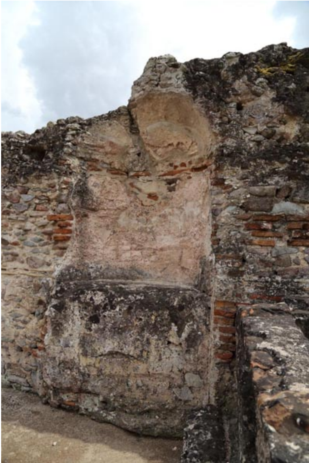
Fig. 5 - El nicho al lado de la bañera que habría contenido una estatua decorativa (foto de Unicity S.p.A.).
