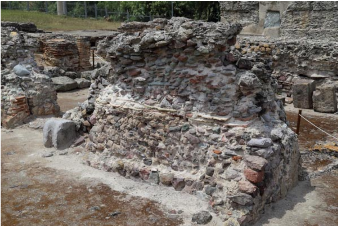
Abb. 4 - Wand des Tepidarium mit deutlichen Spuren von Erosion, die die innere Struktur der Mauer freigelegt hat (Foto von Unicity S.p.A.).
